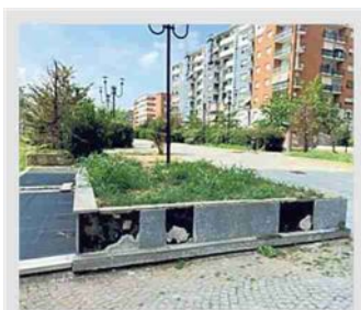
Lo stato di abbandono dell'area
